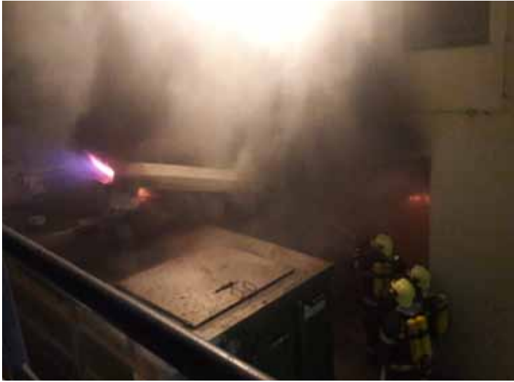
1. Jänner: Brand in einem Biomasseheizwerk
